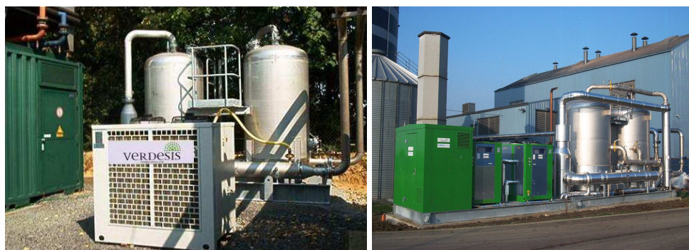
Traitement des siloxanes à la décharge de Braine-le-Château exploitée par Biffa.
