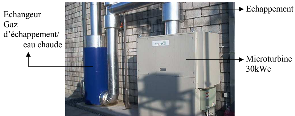
Figure 1 : Unité de cogénération conçue par Verdesis à partir du biogaz de la station d'épuration des eaux de Marche-en-Famenne.
