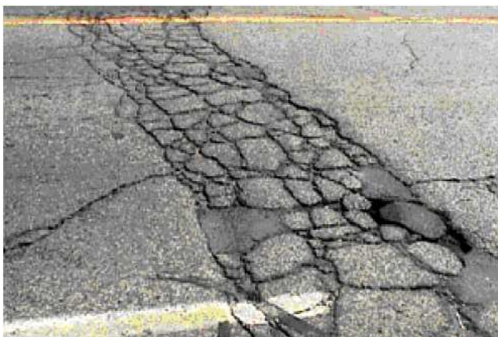
Figure 1 : Exemple de détérioration routière suite à un mauvais remblai (crédit: M. Lemire, L. D'Amours; CERIU novembre 2006; Remblayage des tranchées, sommaire des pratiques courantes au Québec et recommandations)
