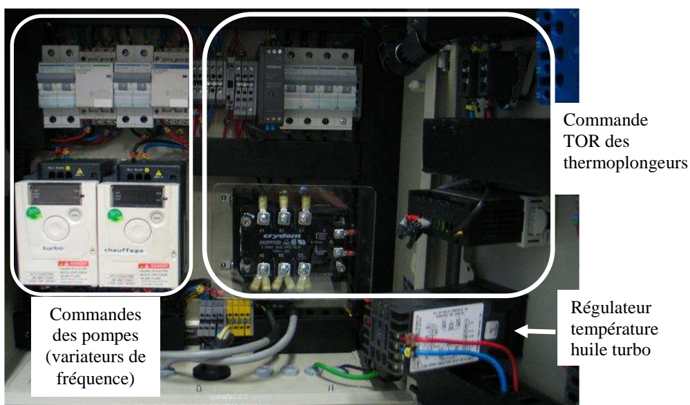
Figure 12 : l'intérieur du coffret électrique
